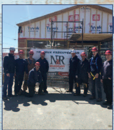
Les travailleurs de la compagnie N&R Duguay, sur un chantier commercial à Gascons, en Gaspésie (contremaître : Pierre Aspirot).
