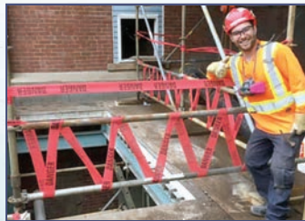
La prudence est une priorité avec Jordan Guimond! Chantier RCC au Témiscamingue.
